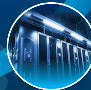
AI Data Center
